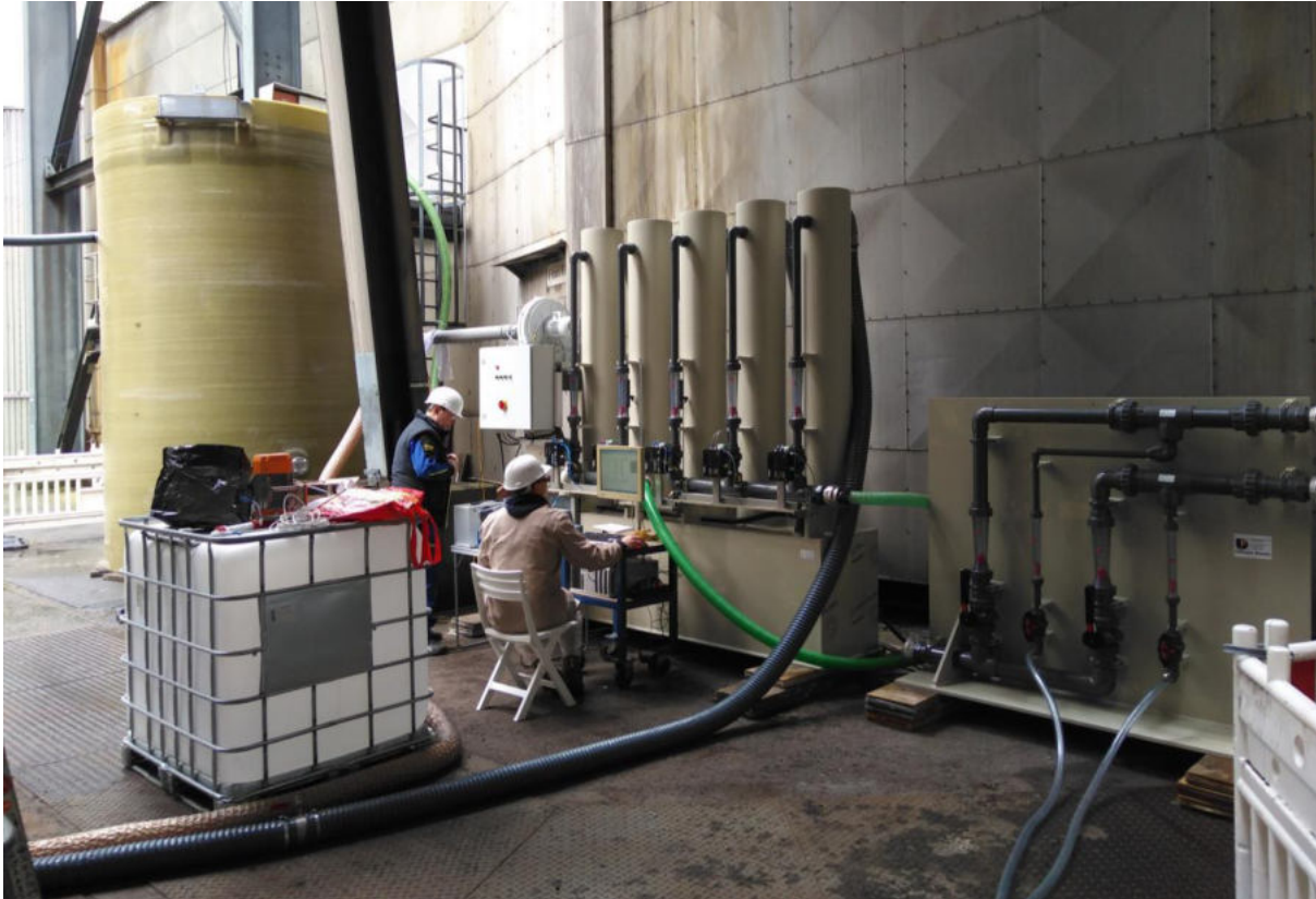
Abb. 2: Versuchsanlage – CO 2 -Wäscher. Standort: REA Innenhof. Ab- und Reingasführung direkt vom/zum Kamin.
