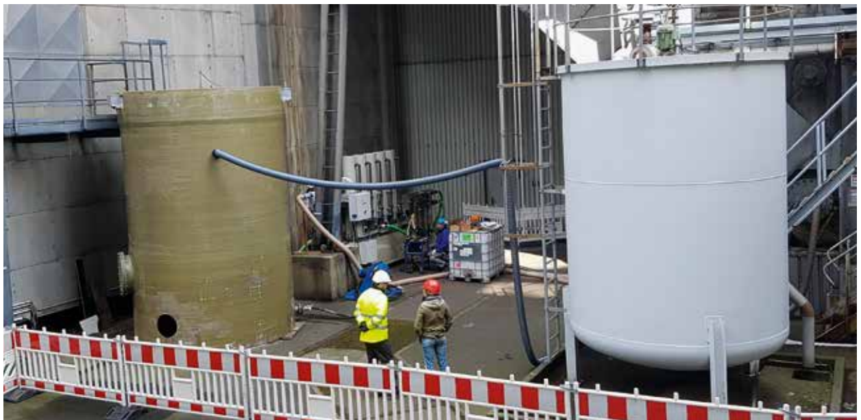
Abb. 2: Versuchsanlage (Wäscher, Strahlpumpe, Vorlagebehälter und Dortmund-Brunnen) am Kraftwerk Wilhelmshaven
